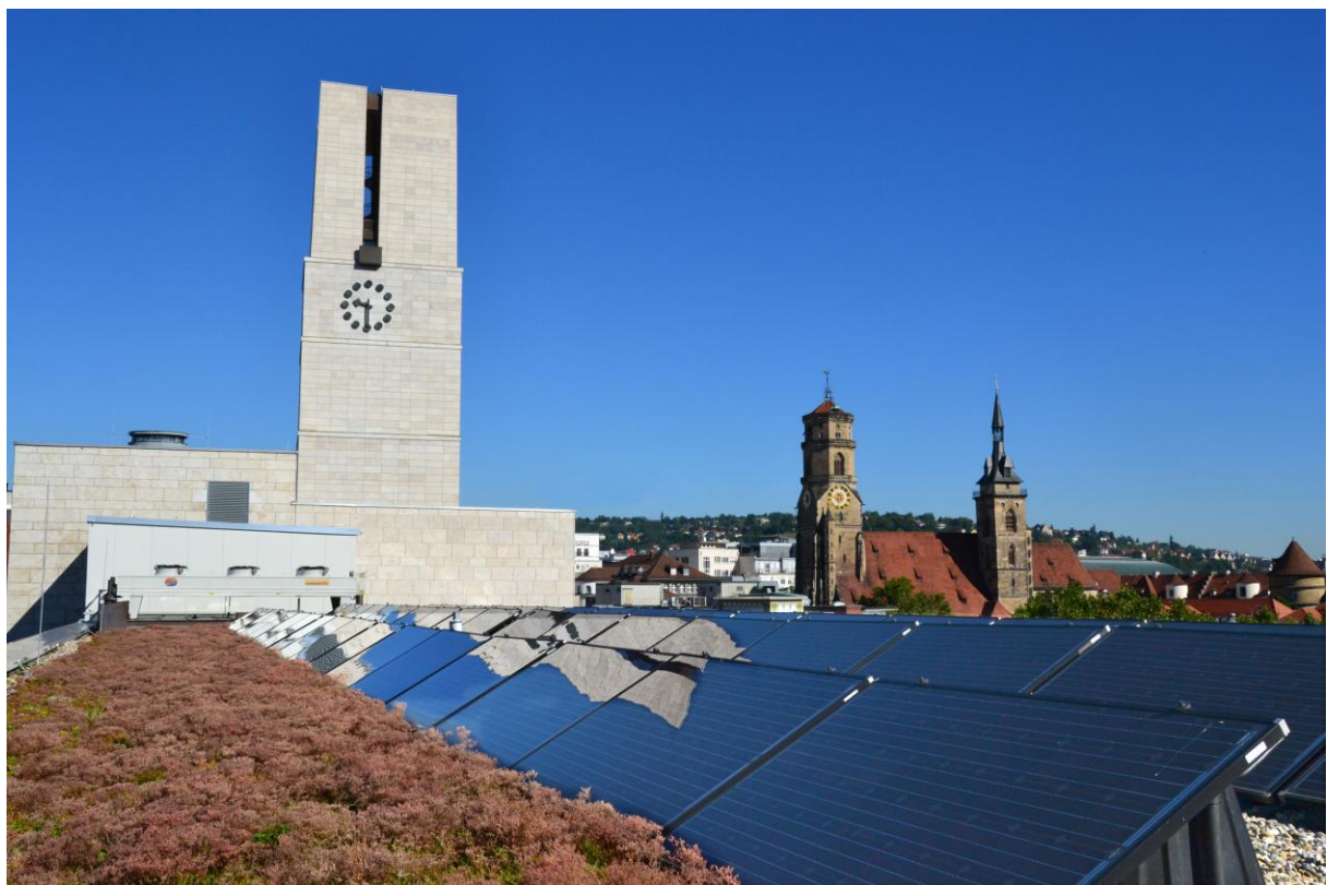
Photovoltaik-Anlage auf der Rathauspassage
